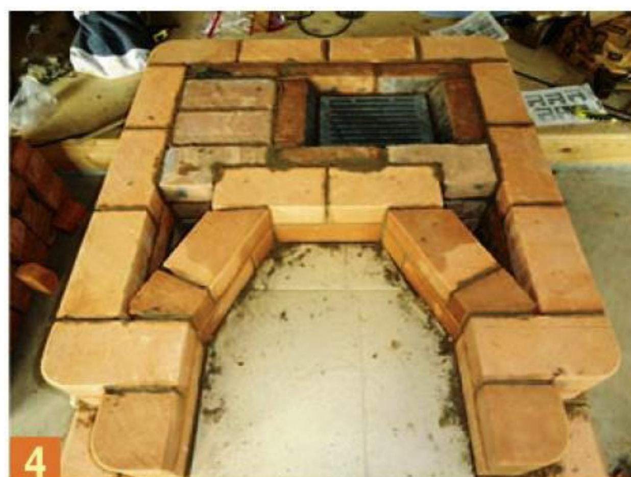
4 За боковыми стенками топки камина идут дымоходы печи.
